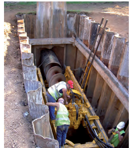
Pour passer sous les remparts de la ville, la seule solution a été le recours à une technique sans tranchée
