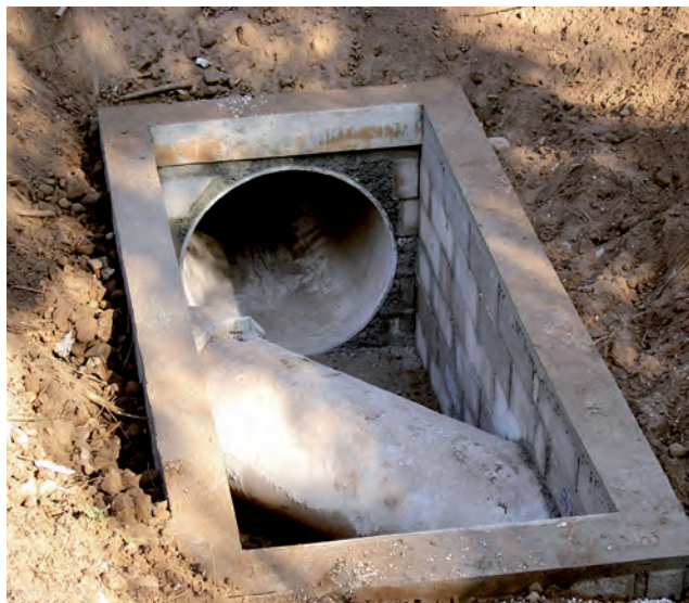
Lors des croisements des tracés de l'ancien et du nouveau collecteur, des regards ont été mis en place.
