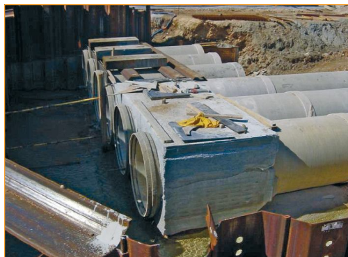
A Six Fours les Plages, les tuyaux PRV en DN2000 sont interconnectés via une chambre en béton qui accueille également le local technique.
