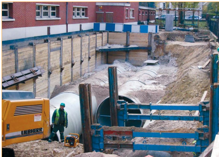
La surface allouée à la mise en place du bassin de rétention étant très étroite, c'est le PRV qui a remporté la mise à Villeneuve la Garenne !
